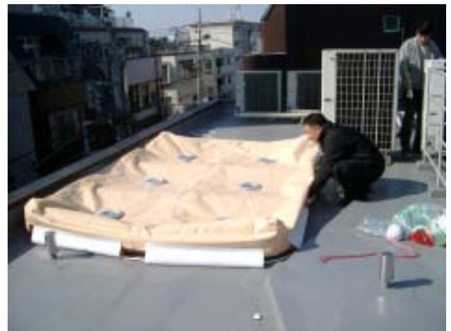
ビル屋上で雨水集水装置設置 (建築家・黒岩哲彦氏)
